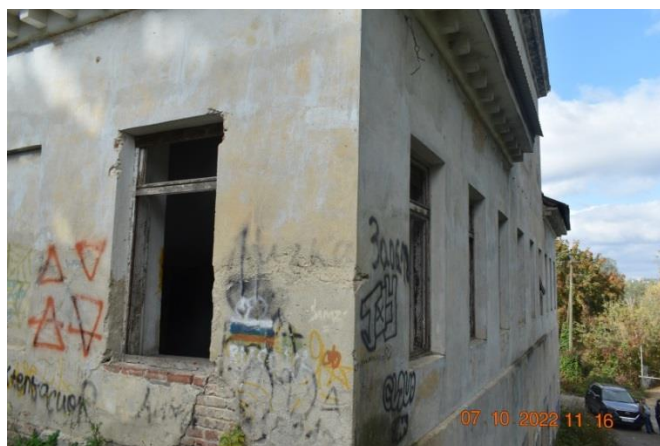
Фото 6. Объект культурного наследия «Дача Башкирцевых». Воронежская область, г. Семилуки, ул. Дача, 1а. Стены. Нарушение целостности, отпадение штукатурного слоя.
