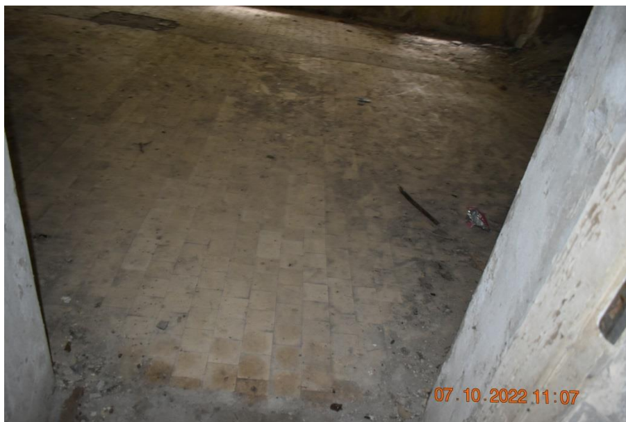
Фото 12. Объект культурного наследия «Дача Башкирцевых». Воронежская область, г. Семилуки, ул. Дача, 1а. Полы. Загрязнение, отпадение плиток.
