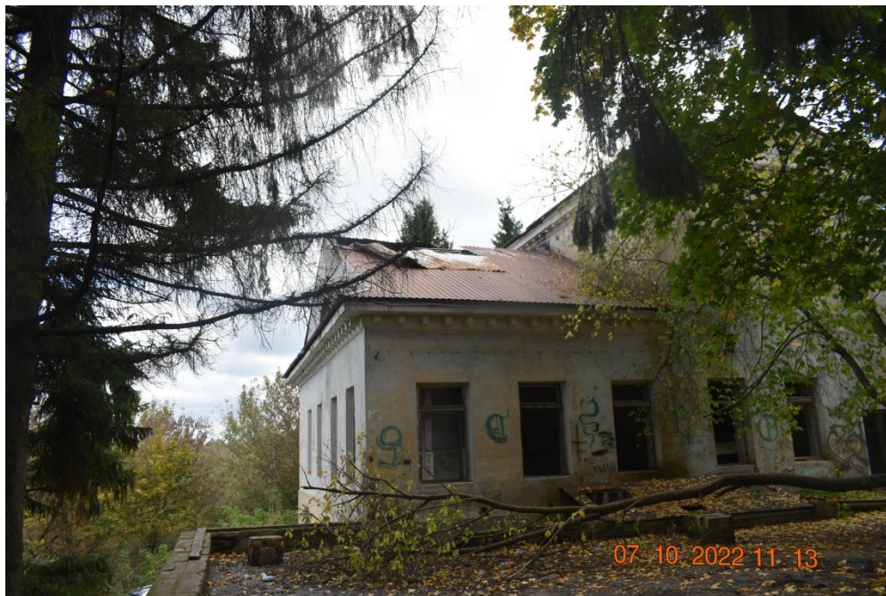
Фото 9. Объект культурного наследия «Дача Башкирцевых». Воронежская область, г. Семилуки, ул. Дача, 1а. Отставание металлических листов кровли.
