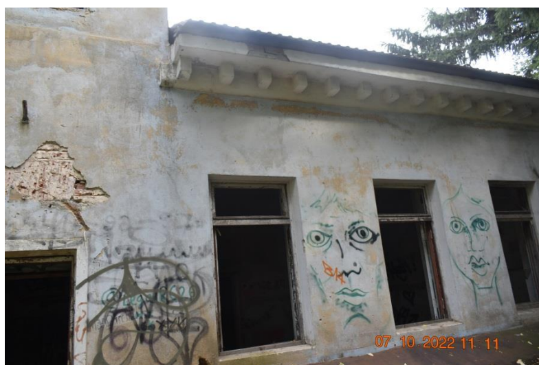
Фото 7. Объект культурного наследия «Дача Башкирцевых». Воронежская область, г. Семилуки, ул. Дача, 1а. Стены. Нарушение целостности, отпадение штукатурного слоя.
