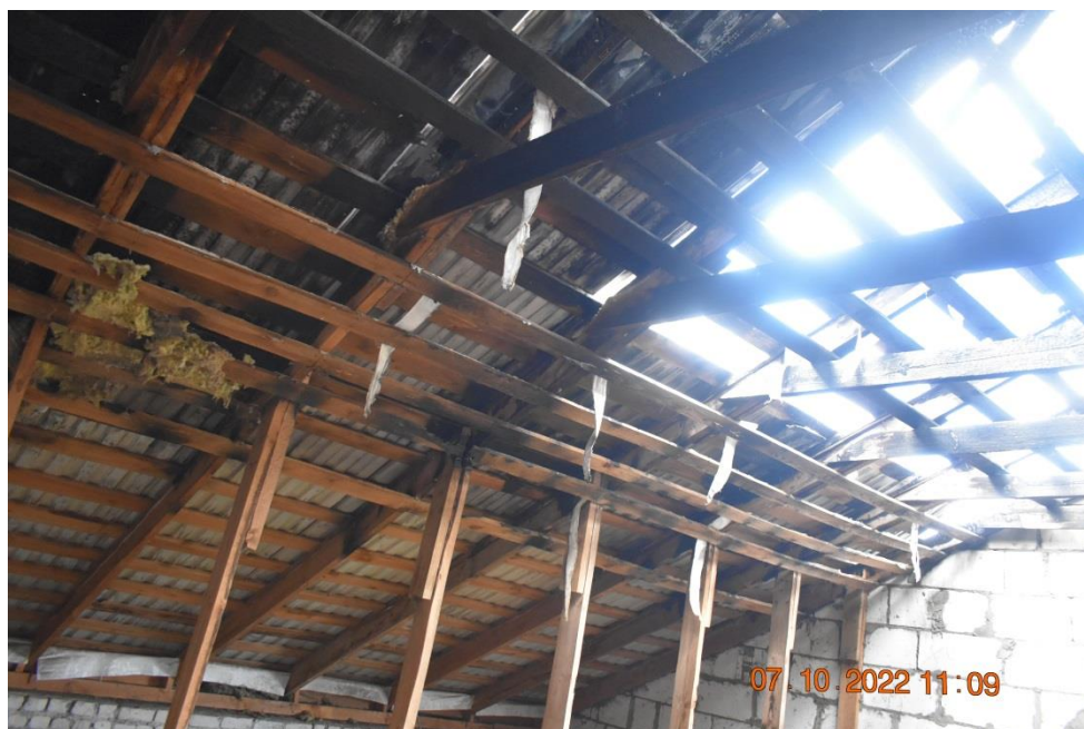
Фото 8. Объект культурного наследия «Дача Башкирцевых». Воронежская область, г. Семилуки, ул. Дача, 1а. Повреждения крыши в результате воздействия огня.
