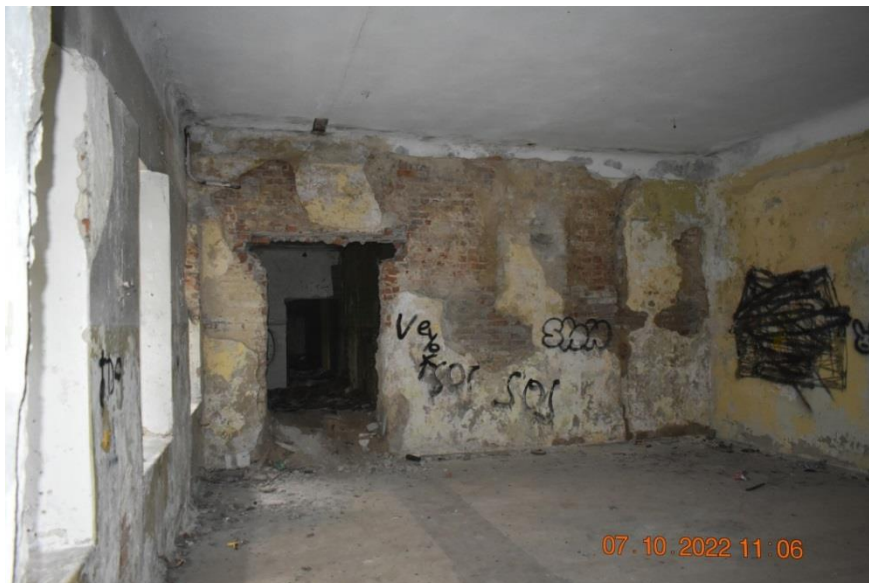
Фото 10. Объект культурного наследия «Дача Башкирцевых». Воронежская область, г. Семилуки, ул. Дача, 1а. Нарушение целостности, отпадение штукатурного слоя. Покрытие полов отсутствует.
