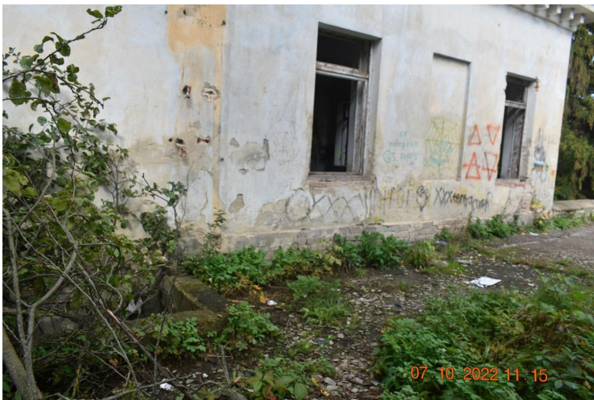
Фото 4. Объект культурного наследия «Дача Башкирцевых». Воронежская область, г. Семилуки, ул. Дача, 1а. Отпадение штукатурного слоя. Наличие растительности в непосредственной близости к цоколю.
